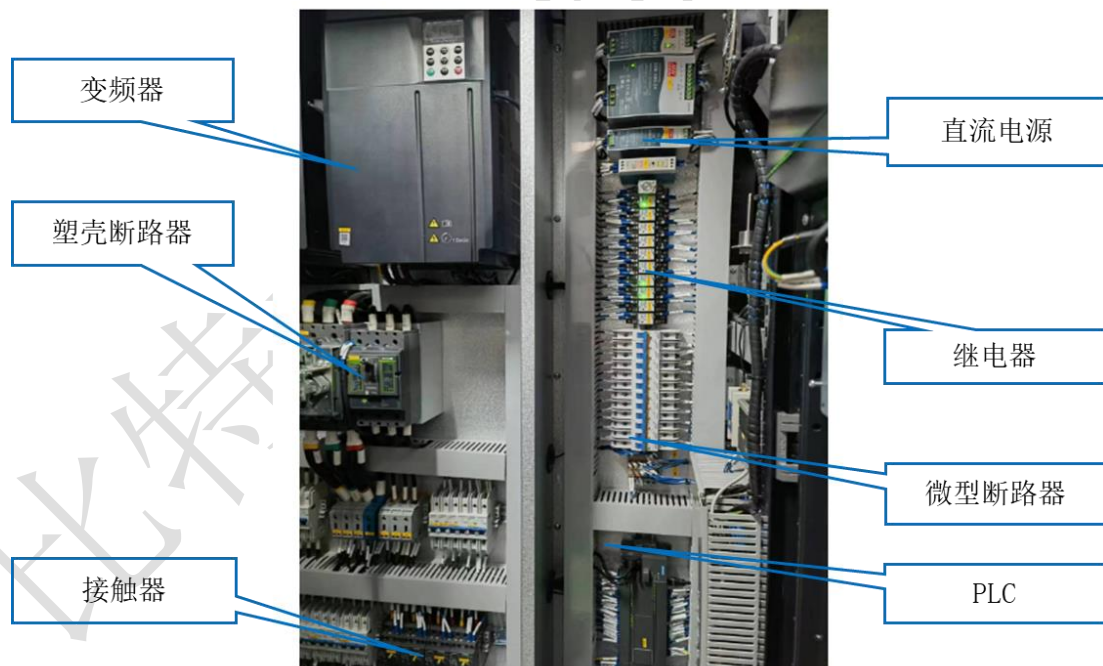
图 5-6 主控制柜内部视图
